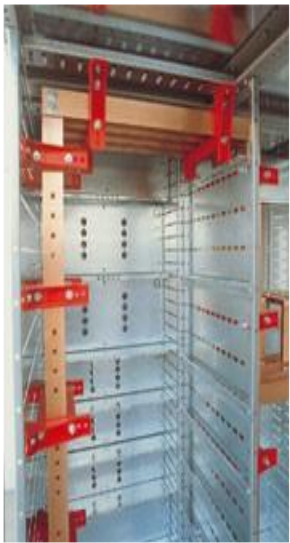
Interno Quadro (PC)
